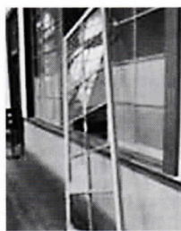
23年3月撮影 窓が破損した 脱落し破損した 脱(大震災直後の)
