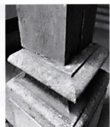
か柱 座の台 大震災により はみでた ら(平成23年8月撮影)
