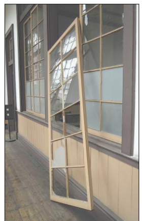
脱落した窓枠
